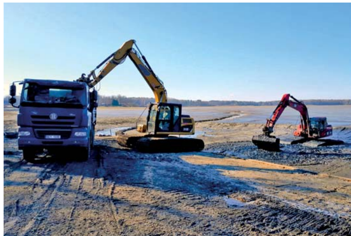
Odbahnění loviště před plánovanou sanací
