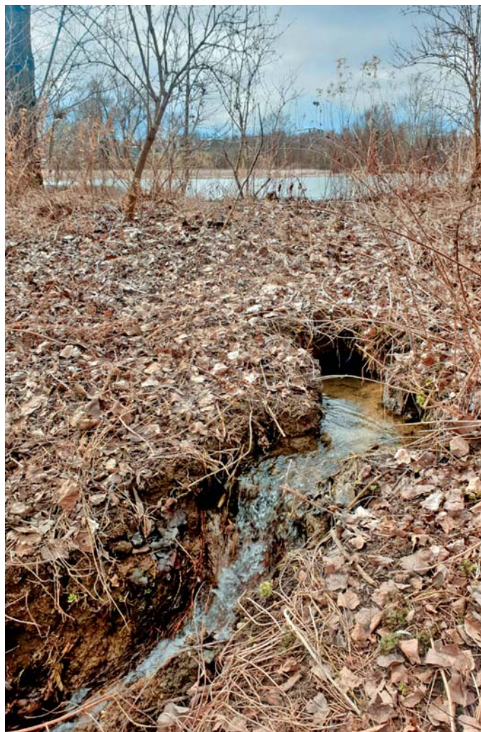
Narušená hráz rybníka Choryně.
